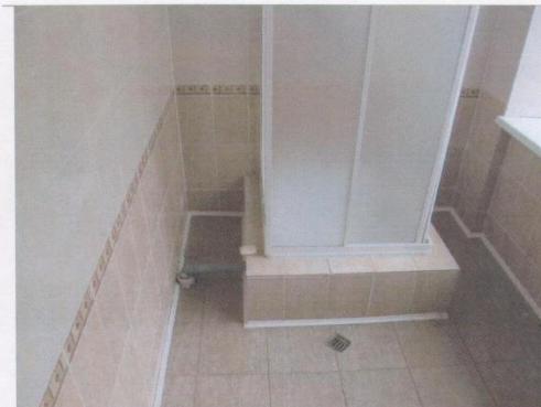
Фото №30 - Санитарно-гигиеническое помещение (душ)
